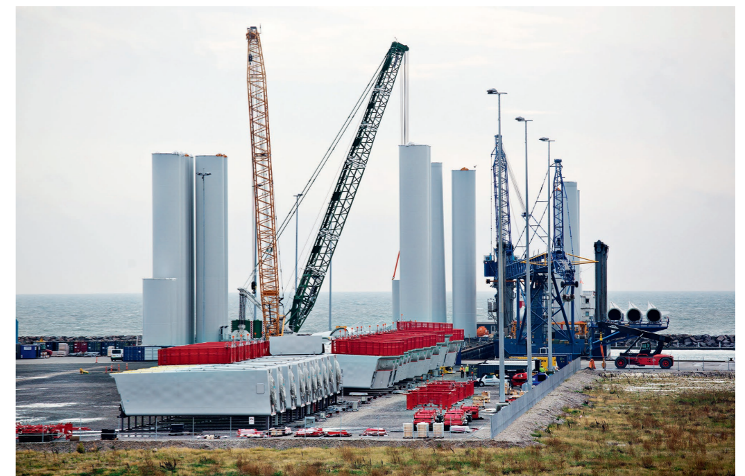
Dong Energy valgte i 2013 Grenaa Havn som pre-assembly hub og udskibningssted for havmøllerne til Anholt Havmøllepark.
